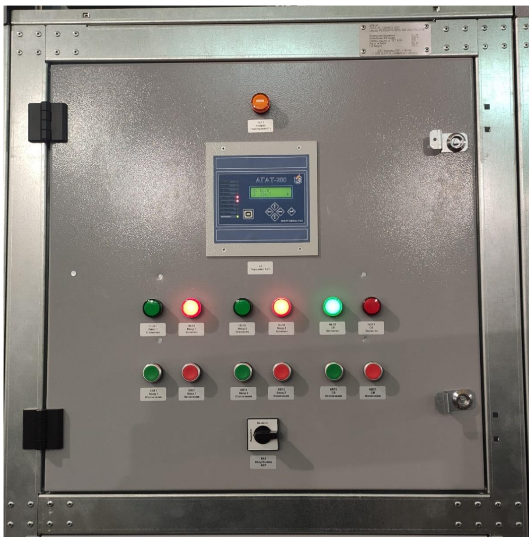
Рис. 4. Дверь модуля вторичных цепей шкафа ШРНН
