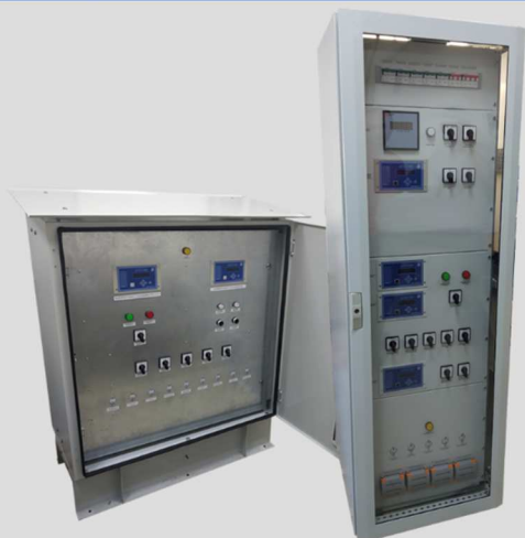
Шкафы РЗА 6-35кВ типа РШ, ШЗА
